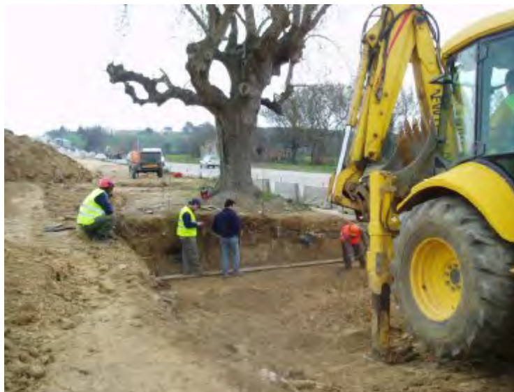
Inicio de los trabajos de trasplante de un fresno singular afectado por las obras de la nueva A2. El cepellón que se preparó tuvo un peso final de 63 toneladas.
