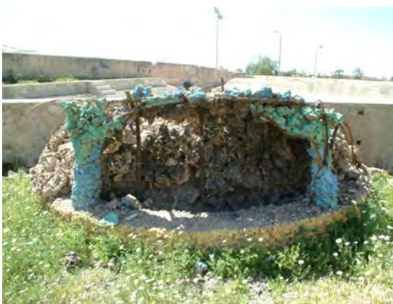
Fuente ornamental deteriorada
