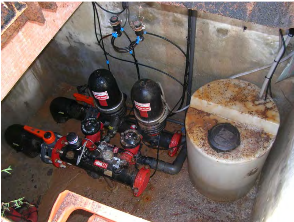
Sistema de filtración Parque Maristas (Valencia). Se encuentra oculto bajo una loma. Batería de 2 filtros automáticos de anillas SKS de Arkal.
