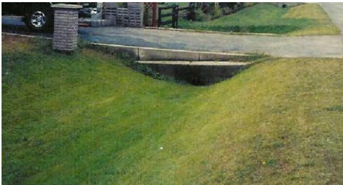
Cuneta verde en una urbanización del Reino Unido.
